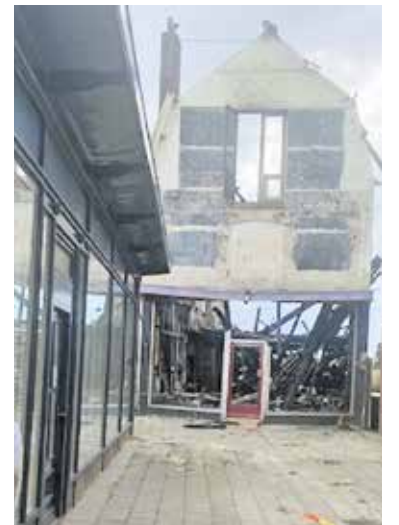
De resterende gevel na de brand.
